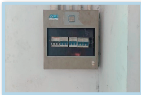
配電盒蓋板損壞，已更換
