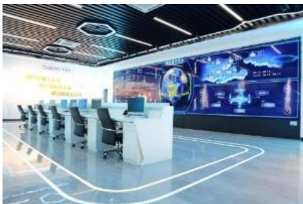
供電系統智能調度指揮中心
