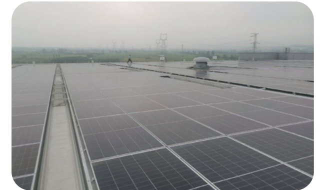
園區光伏電板
