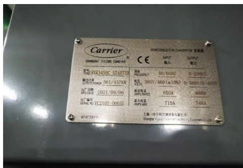
空調冷源製備變頻離心機組
