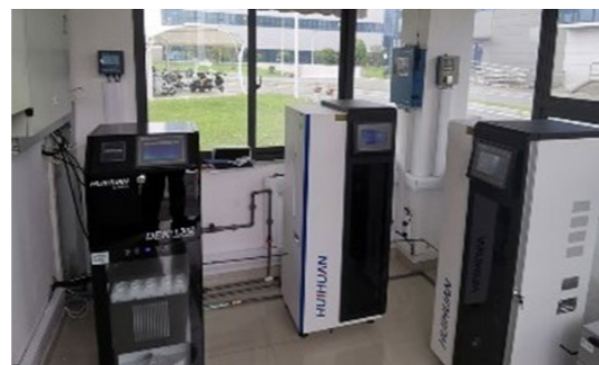
水污染監測設備
