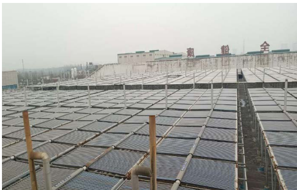
Solar Collectors 太陽能集熱設備
