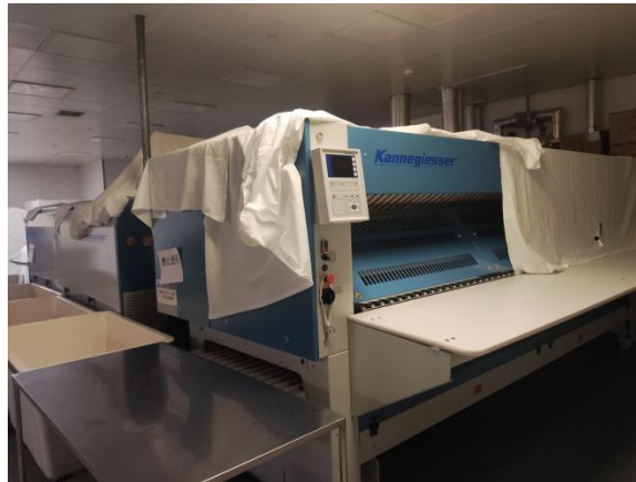
图 诺金酒店洗衣房布草外洗，洗衣房设备停用
