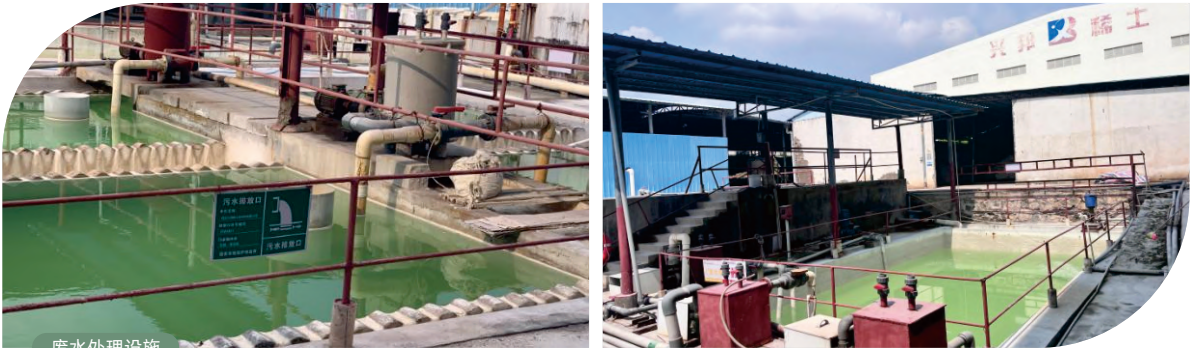
废水处理设施
