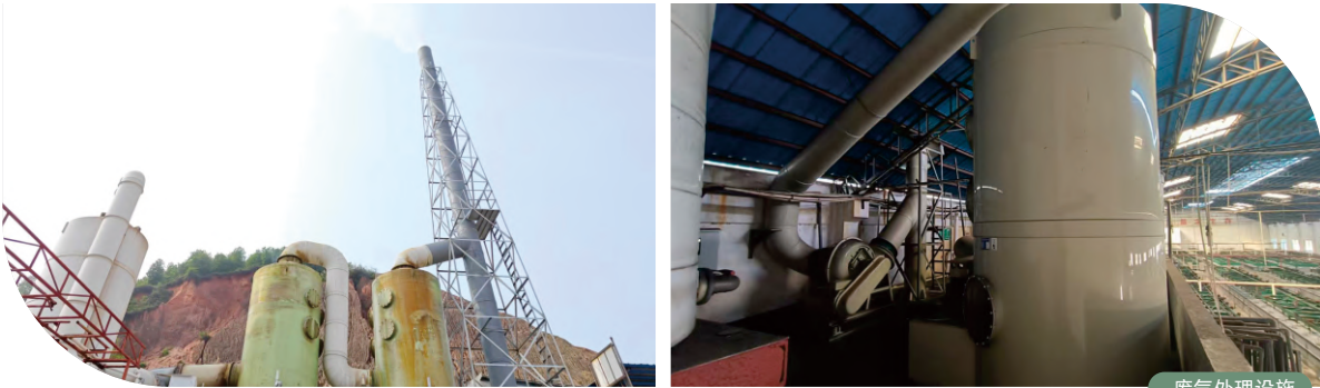
废气处理设施
