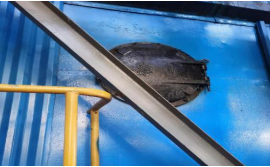
锅炉炉门改造前(卡扣式)
