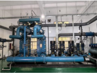
改造后的西区换热站机组
