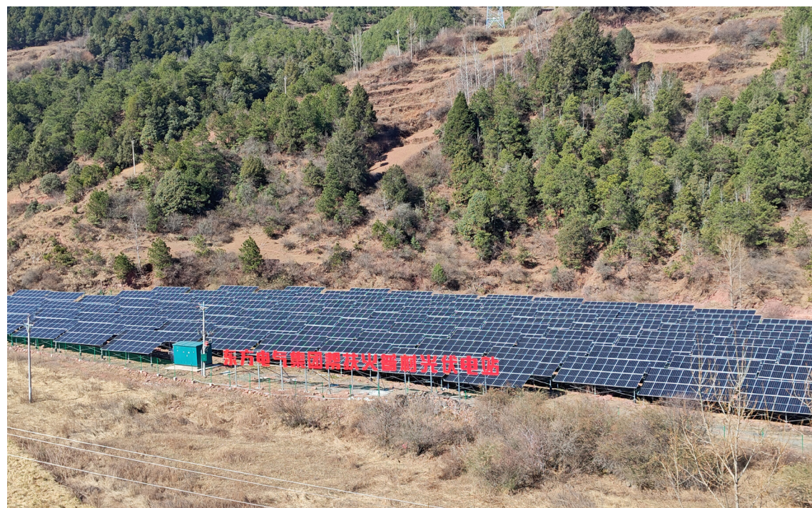
火普村光伏电站
