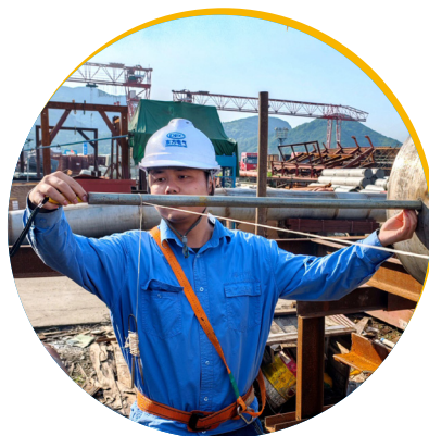
东方锅炉六横 项目现场工程 代表正在测量 现场排汽管尺 寸超差
