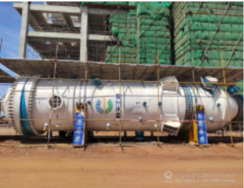
航天粉煤加压气化装置应用于赞比亚项目
