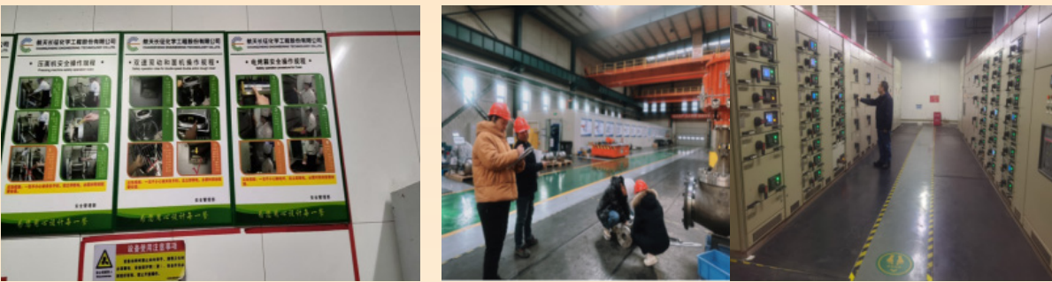
严格落实安全操作规程 定期开展园区、厂房电气公辅设施设备巡检
