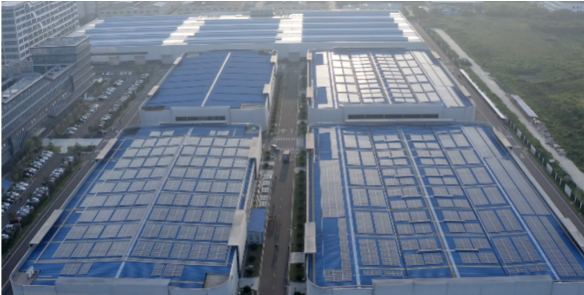
光伏设备发电现场
